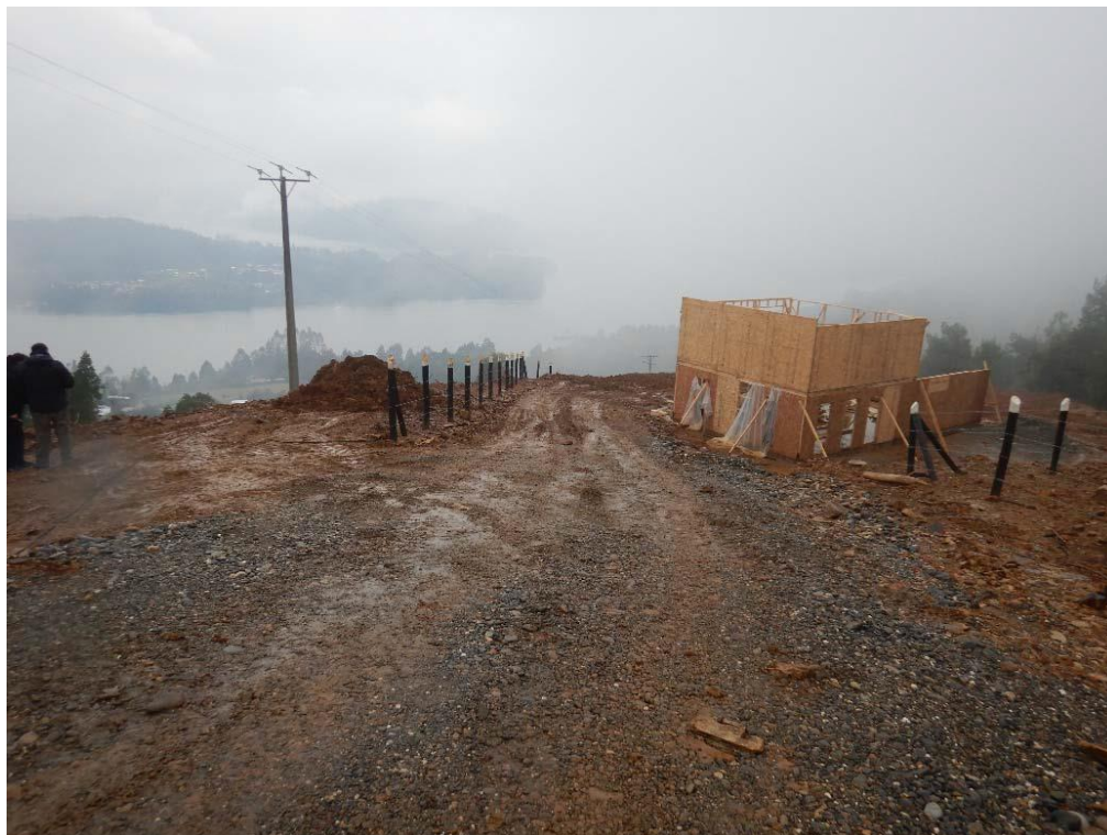
Figura 23. Faenas de construcción de casa habitación en el proyecto Cutipay I. Se observa que se ha realizado corta de vegetación y remoción de tierra. Fuente: Informe Técnico de fiscalización (DFZ-2020-3310-XIV-SRCA) de la SMA (fs. 171).
