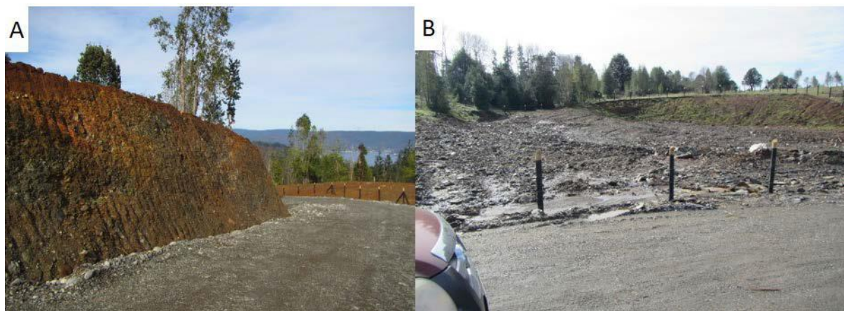
Figura 5. A. Taludes de alto ángulo en caminos. B. Cabecera de quebrada bloqueada por caminos, sin canalizar sus aguas. Fuente: Informe Técnico SERNAGEOMIN (fs. 477).
