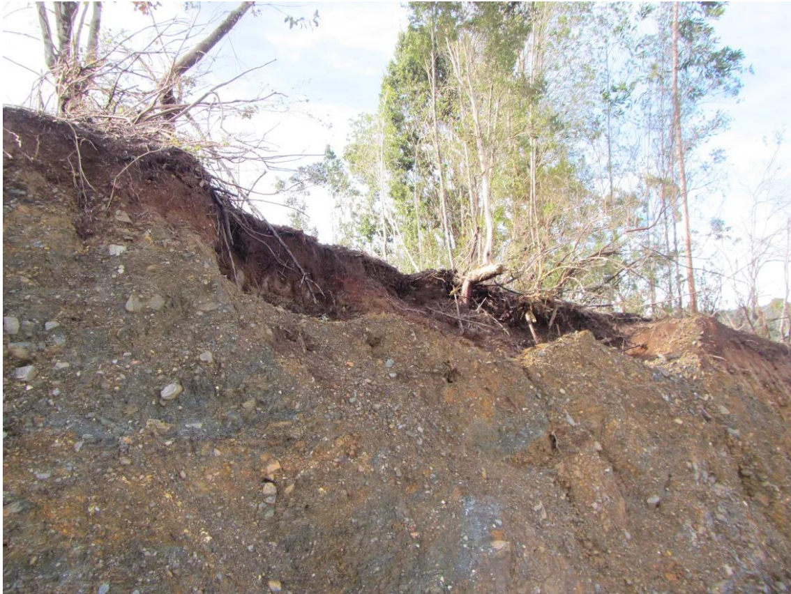
Figura 7. Erosión y deslizamiento superficial en un talud, con exposición de raíces y pérdida de suelo en el sector Los Molinos, Valdivia. Fuente: SERNAGEOMIN, Inspección en terreno realizada el 04 de septiembre de 2020. Fotografía N°70 (Canon PowerShot D30), disponible en la carpeta "1_Sernageomin_fot_09_2020_vistas_loteos" (Archivo comprimido .zip, S/F) acompañado por la demandante a fs. 5034. Coordenadas UTM (WGS84, Huso 18S): Este 639251.42 - Norte 5588709.50.
