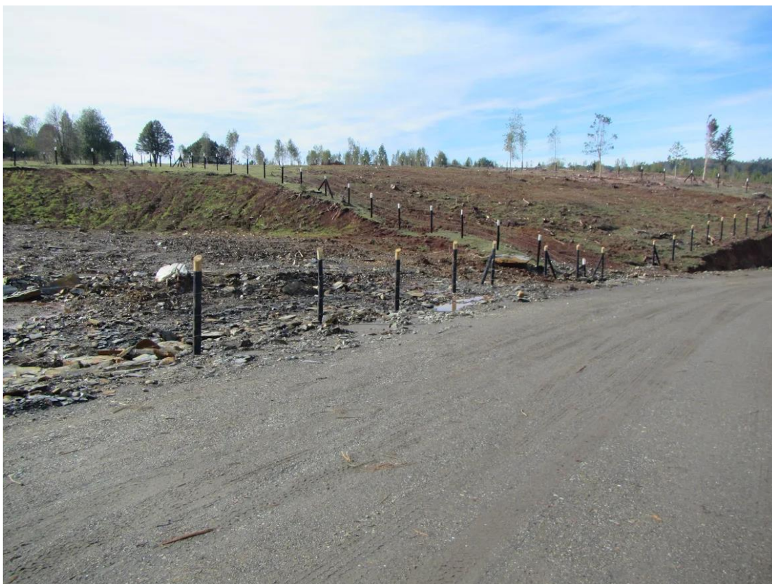
Figura 8. Al fondo, en lo que parece ser un talud, se observan líneas de flujo laminar, evidenciando procesos de erosión superficial asociados a la escorrentía de aguas lluvias. Fuente: SERNAGEOMIN, Inspección en terreno realizada el 04 de septiembre de 2020. Fotografía N°78 (Canon PowerShot D30), disponible en la carpeta "1_Sernageomin_fot_09_2020_vistas_loteos" (Archivo comprimido .zip, S/F) acompañado por la demandante a fs. 5034. Coordenadas UTM (WGS84, Huso 18S): Este 639326.58 - Norte 588747.73.
