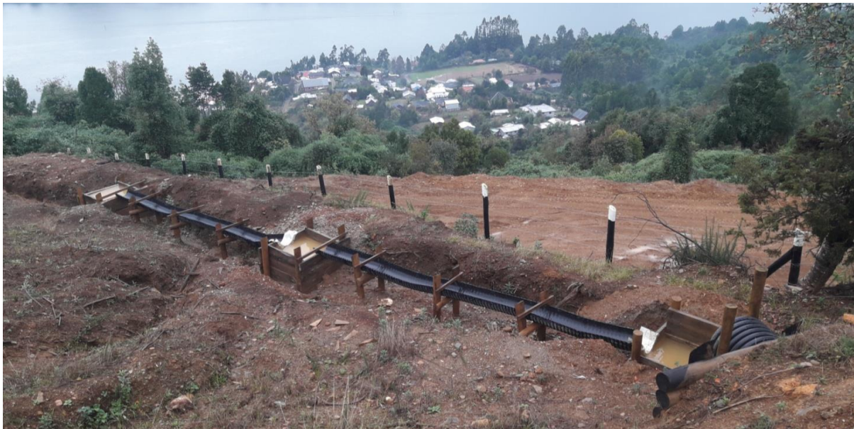
Figura 20. Cámaras de decantación de las aguas lluvias donde además se observa erosión. Fuente: SEREMI de Vivienda y Urbanismo (fs. 1235).
